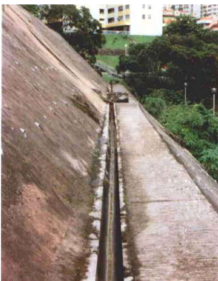
(a) Canaleta transversal
