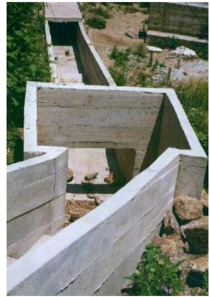
(c) caixa de passagem
